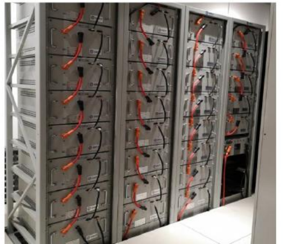
冬奥组委应急供电储能设备项目100KW/221KWH
